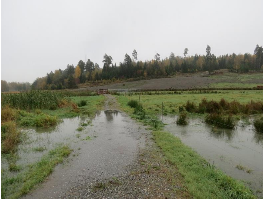
Figur 1. Översvämning av närliggande väg vid höga flöden i dagvattendamm i samband med regn. Foto: Rasmus Elleby 2014-10-09.
