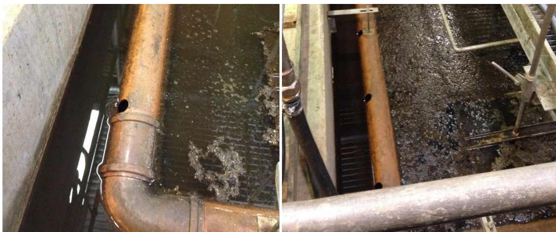
Figur 11 Mellansedimenteringsbassängen. T.v. 23 november. Tjockt slamtäcke på botten av bassängen och viss flytslambildning. T.h. 18 december. Lägre slamtäcke men fortsatt flytslambildning. Foto: Matilde Kamp
