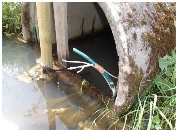
Figur 26. Mycket påväxt av grön/bruna alger och organismer runt de fasta konstruktionerna kunde observeras, foto taget 11 juni 2014. Provtagnings slangarna kunde nås från inloppet.
