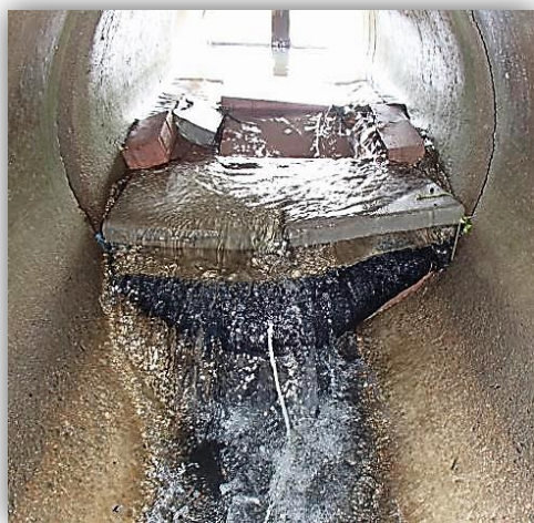
Figur 16. Utloppet av filtret sett inifrån trumman. Vatten strömmade under hela provtagningsperioden ovanpå filtret.
