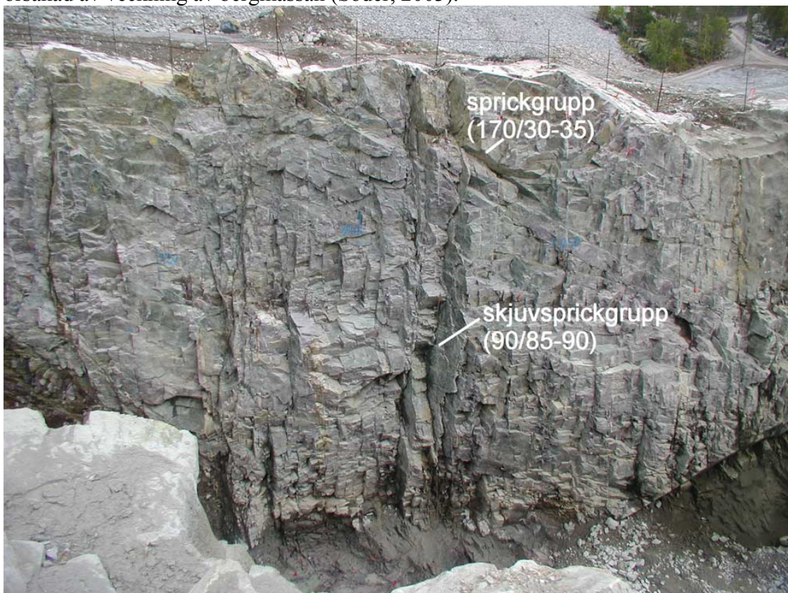
Figur 6.3 Vänstervägg i Satisjaures utskovskanal. De täta sprickavstånden ses tydligt.
