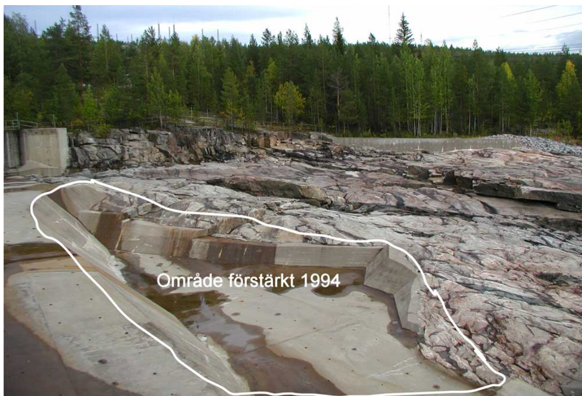
Figur 6.7 Det markerade området nedströms utskoven eroderade bort innan 1993.
