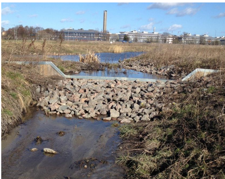
Figur 4. Inloppet till bräddningsdiket vid Kungsängsdammen. Foto: Jonathan Arnlund.
