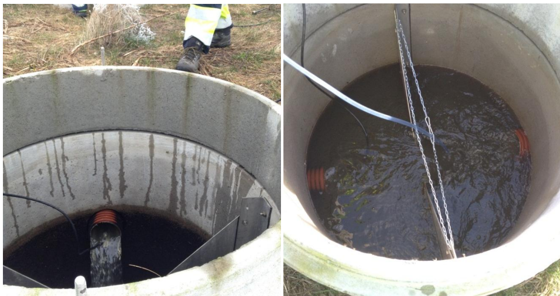
Figur 8. Till vänster: Installation av area/hastighetsgivare vid utloppsbrunnen till Kungsängsdammen. Till höger: Area/hastighetsgivaren och insugsslang installerade. Foto: Jonathan Arnlund.
