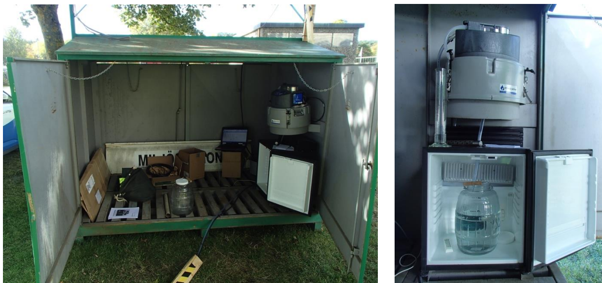
Figur 14. Installation av provtagare. T.v. Containern vid södra provtagningspunkten. Sugledningen och Isco-givarens sladd syns komma in i containern. T.h. Provtagningsslangen leder vattenprovet från provtagaren ned till ett 10 L glaskärl inne i ett kylskåp. På kylskåpet står även det 500 mL mätglas som användes för att kalibrera in provvolymen. Foto: Hannes Öckerman.
