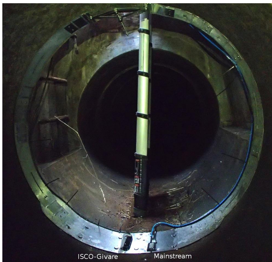
Figur 11. Installation av flödesmätare vid den norra provtagningspunkten. Mainstream och Isco-givaren är den primära respektive sekundära flödesmätaren. Flödesriktningen är inåt i bilden. Rörets diameter är 1400 mm. Högst upp i bilden syns saxmekanismen som håller monteringsringen på plats och mitt i bilden syns en steg som leder upp från nedstigningsbrunnen. I den södra provtagningspunkten installerades Mainstream-mätaren också på en monteringsring, men Isco-givaren fästes istället på en bräda (se avsnitt 3.2.2). Foto: Hannes Öckerman.
