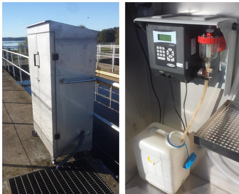
Figur 12. Uppställning av provtagningskåp i slutet på eftersedimenteringen med slang i utloppskanalen och bild inifrån skåpet med provtagare och uppsamlingshink.
