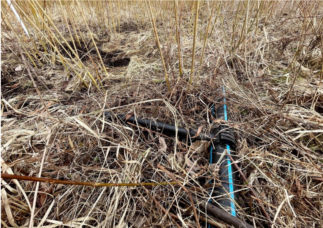
Figur 2 Stamledning och ledning för droppbevattning på salixodlingen.
