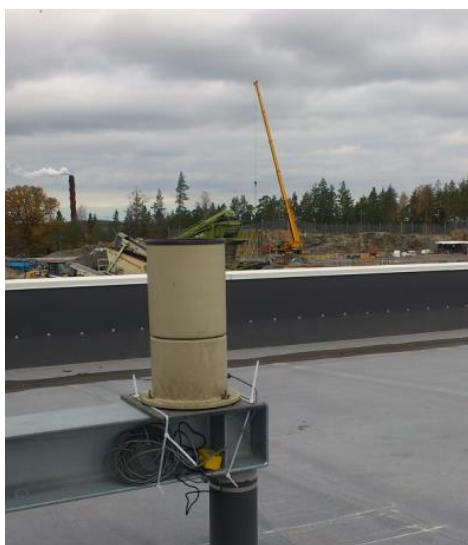
Figur 10. Regnmätare placerad på tak vid Värmdö Marknad.
